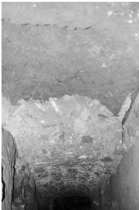
Fig. 303 - Resto del muro di conglomerato di sbarramento della galleria IM2.
