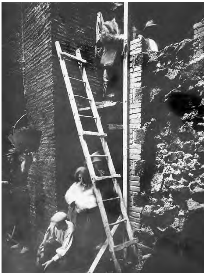
Fig. 349 - Frana nella regione I: operai al lavoro in prossimità del lucernario della galleria I1/I2 (Archivio PCAS).
