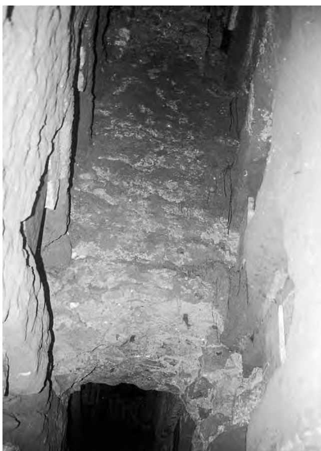
Fig. 153 - Struttura in opera cementizia che invade la galleria F11.
