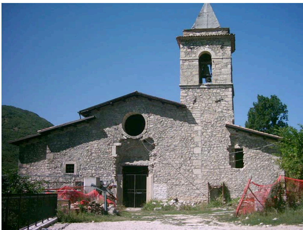
Figura 53. Facciata della chiesa di San Martino di Torano durante i lavori di restauro (2006-2007)
