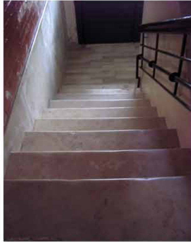
Fig. 2: prima rampa di scale dell'edificio C con balustra modificata per l'inserimento del muro del vano contatori
