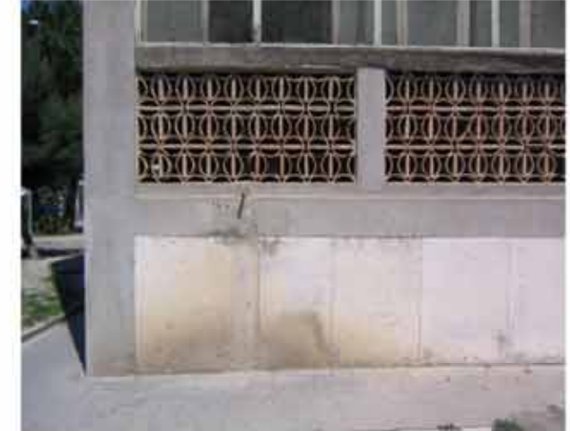
Fig. 48: stato di degrado del basamento in pietra di Trani e degrado esterno del terrazzino triangolare: la balaustra è stata occultata con un nuovo muretto, ed è stato alterato il parapetto sagomato in calcestruzzo
