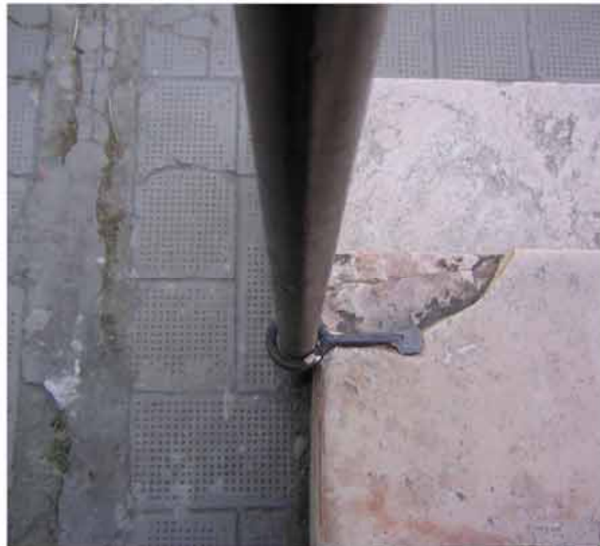
Fig. 5: scala di accesso al tipo E: dettaglio dell'attacco al gradino della scala in pietra del corrimano in ferro. L'inserimento del piombo ha provocato la lesione del gradino
