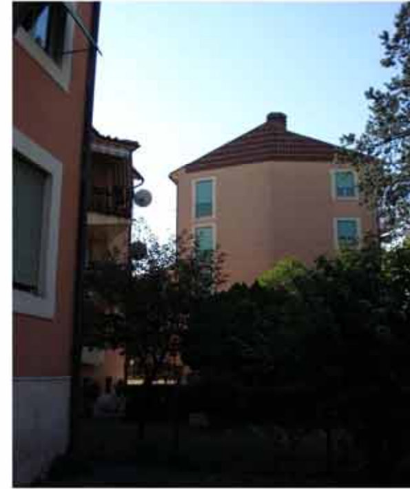
fig.32 vista del retro dell-ultimo edificio / dettaglio dei laterizi sul solaio di copertura
