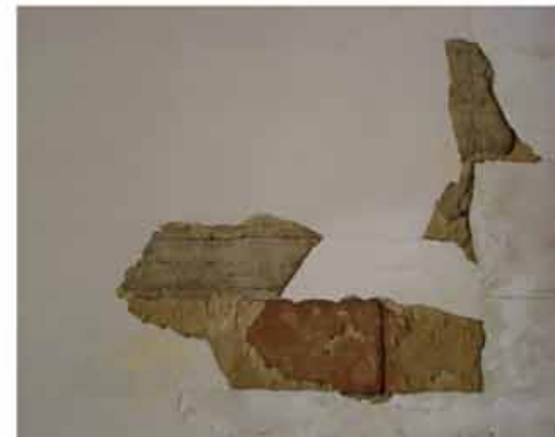
Fig. 33: lacuna dell'intonaco sull'ultimo solaio che ha permesso di riconoscere il solaio SAPAL
