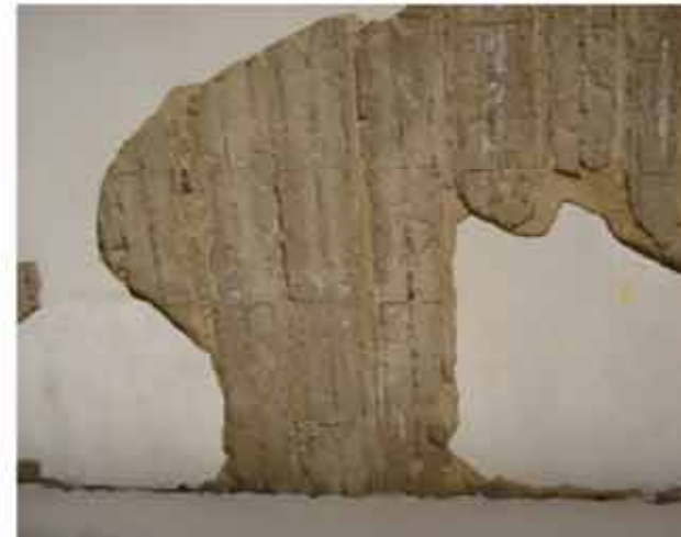
Fig. 32: stato di degrado dell'intradosso della pensilina di copertura del terrazzo di ingresso
