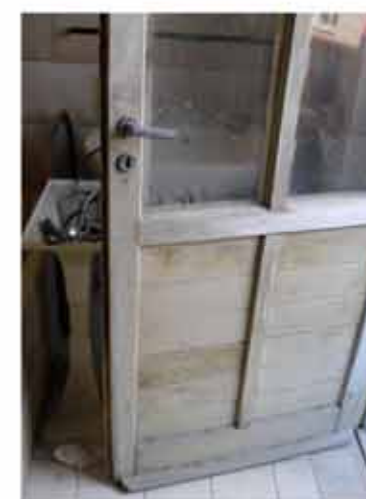
Fig. 37: stato attuale dell'infisso di tipo 7
