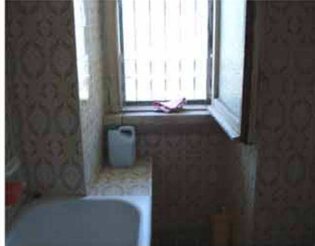
Fig. 45: rivestimenti sostituiti nel bagno e disposizione dei sanitari alterata rispetto al progetto di Ridolfi; la vasca impedisce di accedere comodamente alla finestra
