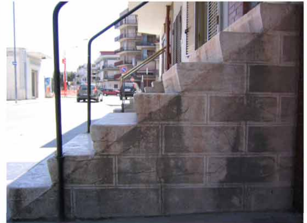
Fig. 7: scala di accesso al tipo E: prospetto laterale della scala in pietra con i giunti disegnati su intonaco
