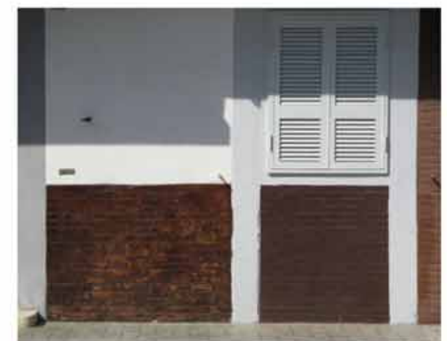
Fig. 38: stato della facciata dove l'intonaco è stato sovrapposto alla muratura di tufo a vista
