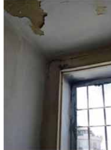
Fig. 47: umidità dell'architrave proveniente dalla facciata esterna
