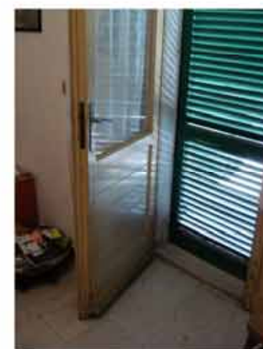
Fig. 36: stato attuale dell'infisso di tipo 8
