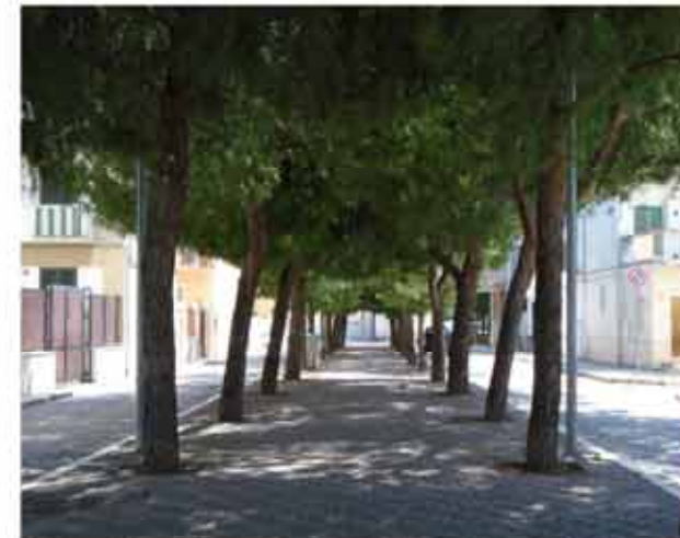
Fig. 14: stato di degrado attuale della pineta su via Calore con la pavimentazione sconnessa a causa delle radici degli alberi
