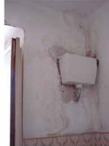
Fig. 46: umidità delle pareti dovuta ad una probabile rottura della colonna montante
