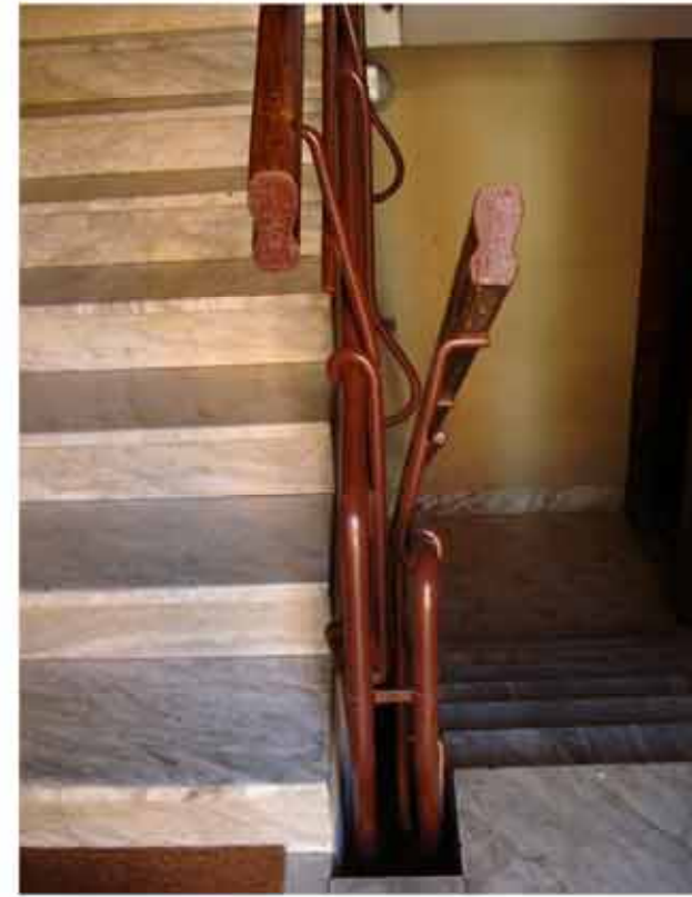
Fig. 11: particolare del corrimano della balaustra del vano scala realizzato secondo i disegni originali a Terni
