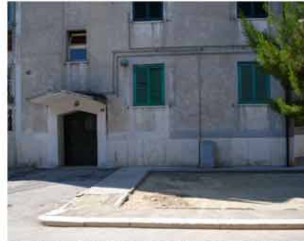
Fig. 13: stato di degrado del piazzale antistante all'edificio di tipo C
