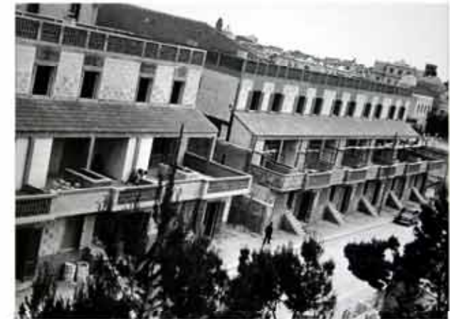
fig. 45: foto di cantiere dei due blocchi delle case a schiera di tipo DE
