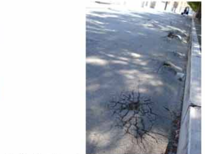
Fig. 15: stato di degrado del manto stradale a causa delle sconnessioni dell'asfalto causate dalle radici dei pini
