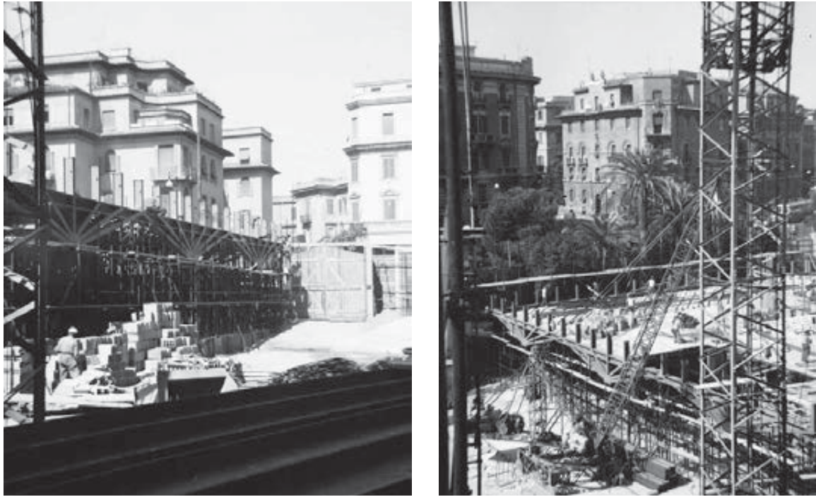
Fig. 9, 10 - Viste del cantiere (AR, FC_03_EdificioPiazzaSassari_n.21 e n.29 su concessione dell'Università degli Studi di Padova - Ufficio Gestione Documentale)
