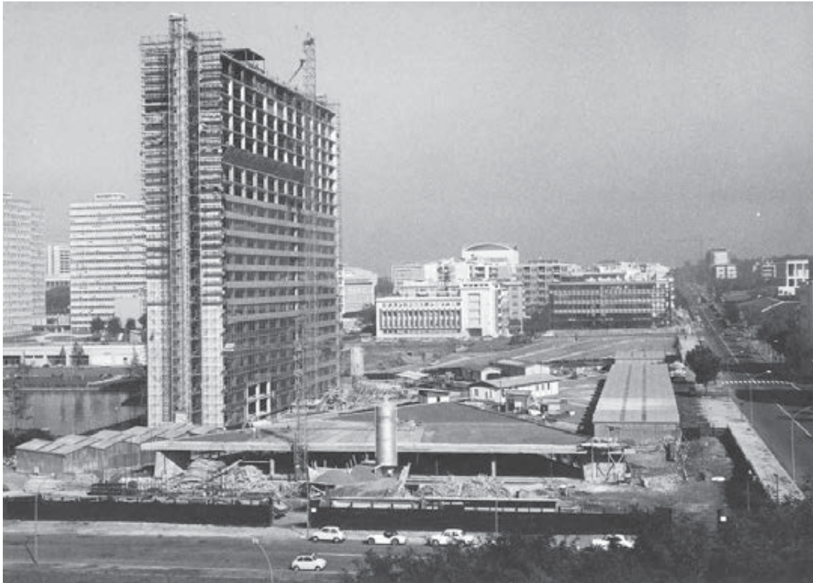
Fig. 14 - Vista del cantiere con la facciata in fase di completamento, ottobre 1961 (ASE)
