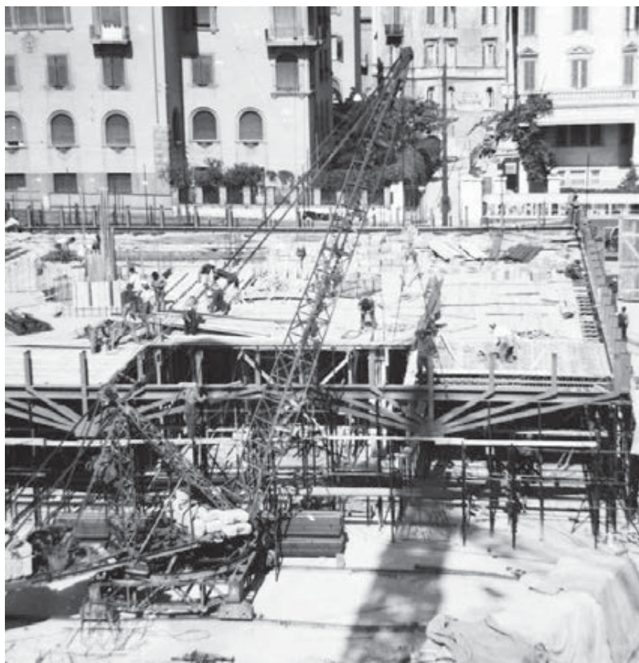
Fig. 14 - Vista del cantiere (AR, FC_03 EdificioPiazzaSassari n.25/n.27 su concessione dell'Università degli Studi di Padova - Ufficio gestione documentale)
