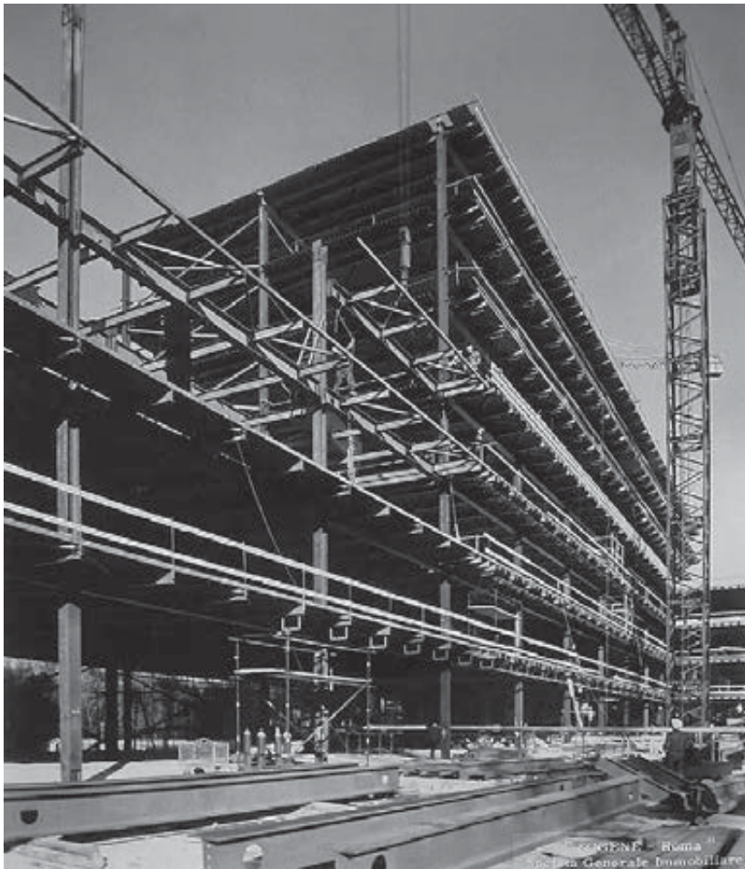
Fig. 9 - Uffici dell'Immobiliare, la struttura di acciaio in costruzione, 15 marzo 1966 (ACS, SGIS, Album fotografici, b. 16)
