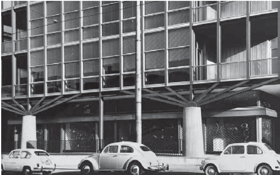
Figg. 15-17 - Viste di dettaglio. Visibile il nodo tra la struttura metallica e il pilastro in cemento armato con la particolare soluzione del capitello a ventaglio (AI, faldone 1116)
