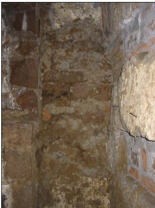
Figura 14 - Angolo nord-ovest parete settentrionale. Tracce di scialbatura.
