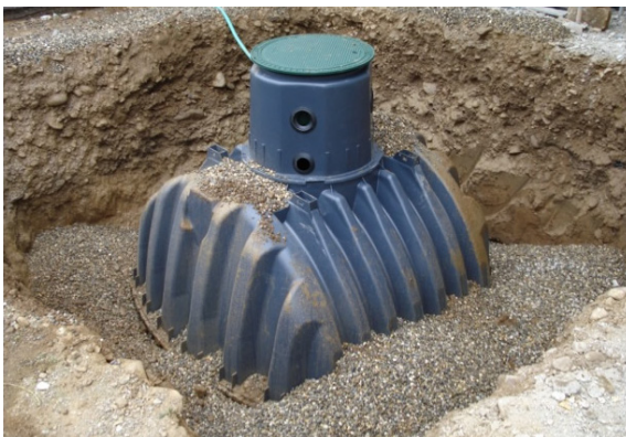
Fig. 5: Serbatoio di raccolta dell'acqua piovana interrato
