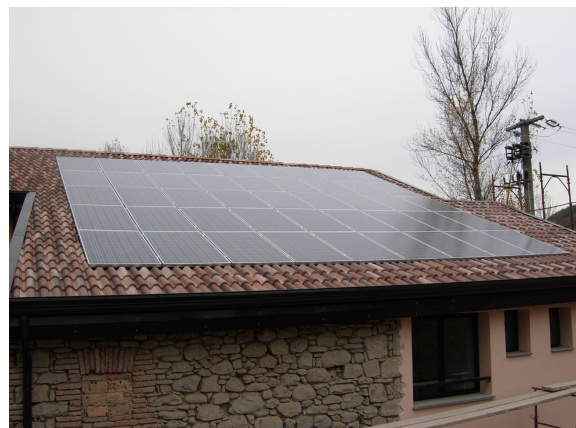
Fig. 35: Pannelli fotovoltaici integrati nel manto di copertura
