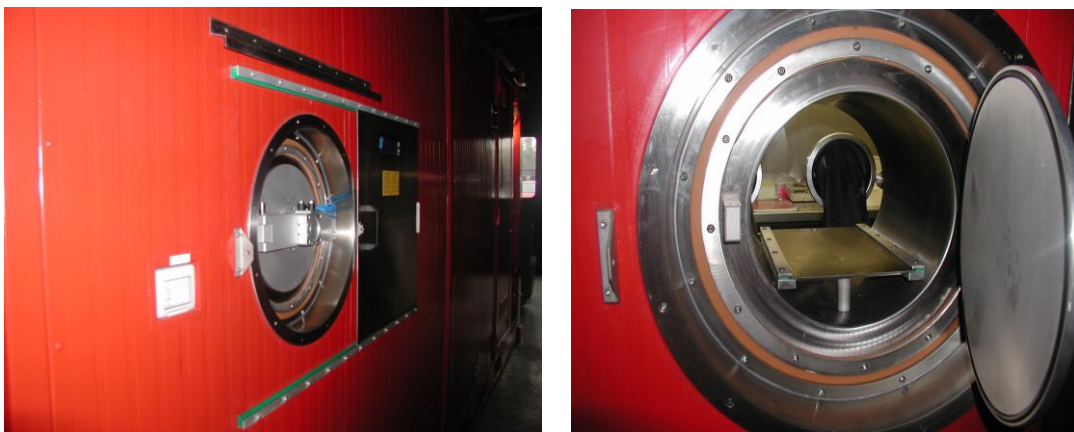
Figura 68 il portello esterno della pass-box e a dx l'interno della pass-box
