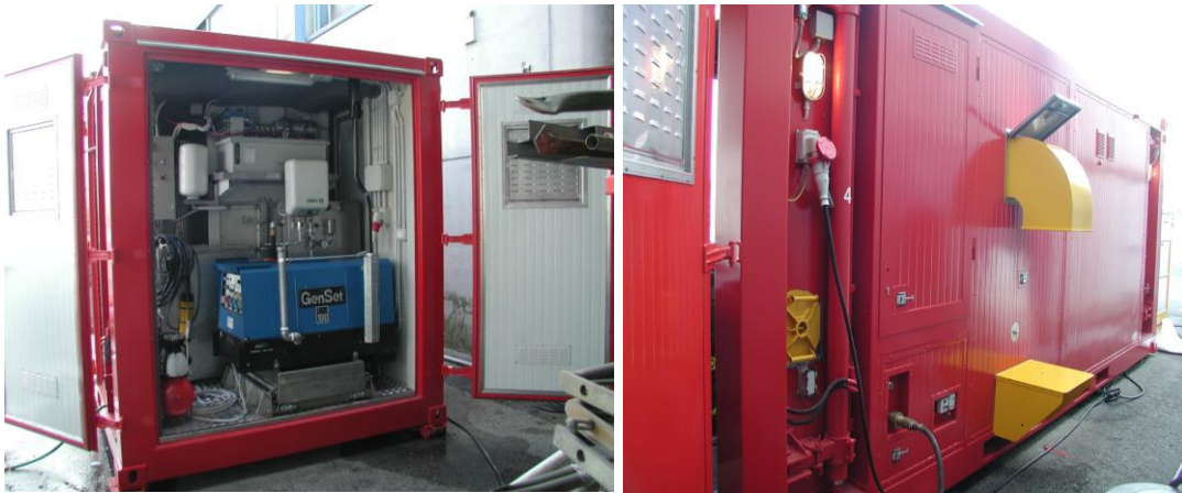
Figura 62 il vano tecnico e a dx il sistema di espulsione dei rifiuti solidi non pericolosi
