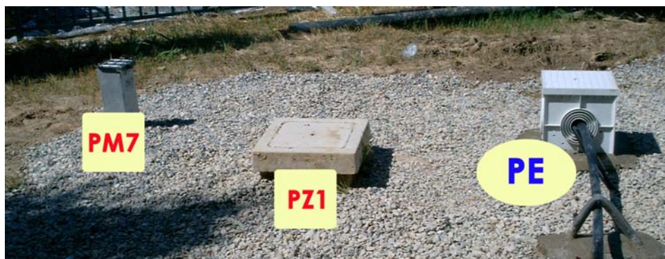
Figura 10-28 – Particolare dei pozzi di immissione-estrazione
