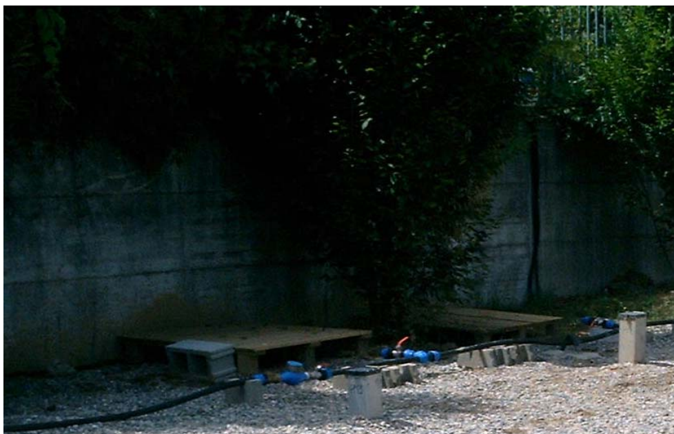
Figura 10-33-Localizzazione dei serbatoi di stoccaggio
