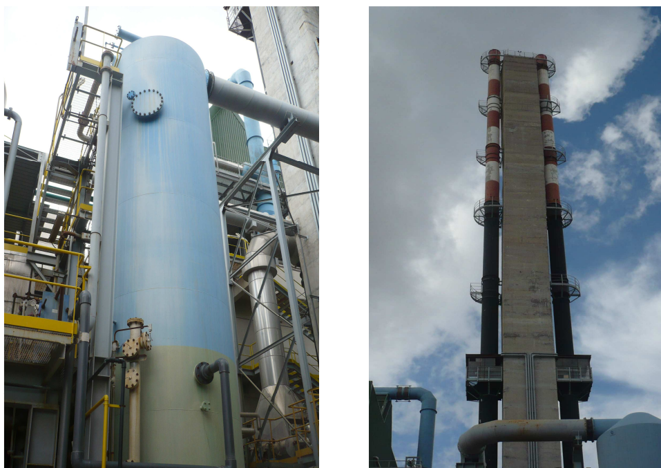
Figura 6.6: torre di lavaggio e camino bicanna di evacuazione fumi
