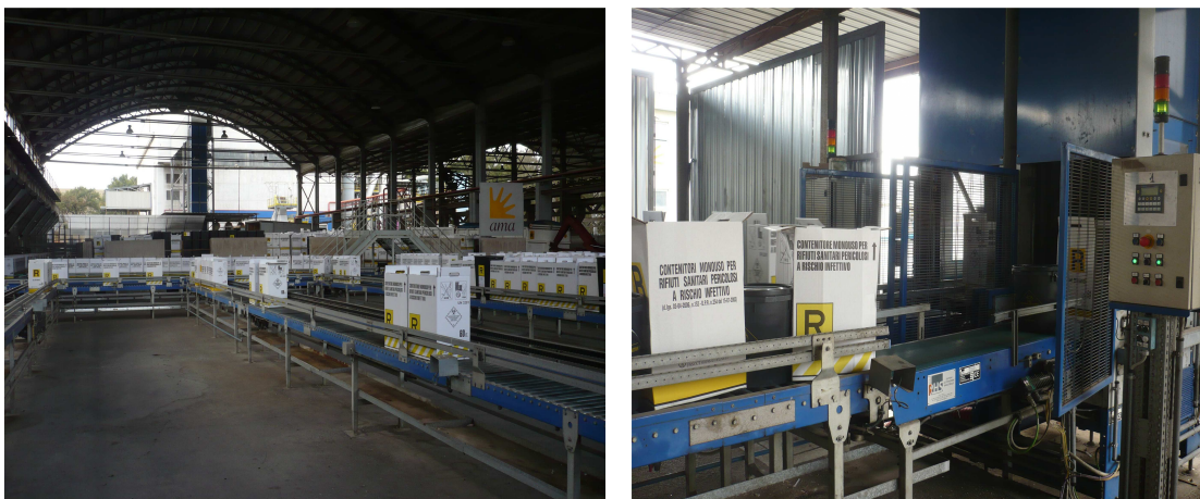
Figura 6.2: sistema di alimentazione ai forni: baie di carico e nastro trasportatore
