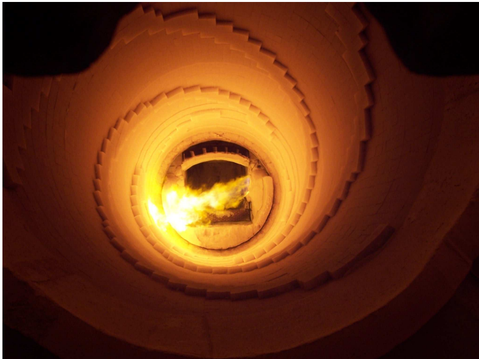
Figura 6.4: interno del tamburo rotante in fase di preriscaldamento con bruciatori
