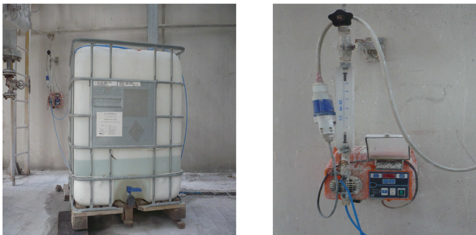
Figura 7.2: serbatoio di accumulo della soluzione di \text{NH}_3 e pompa elettromagnetica con flussimetro
