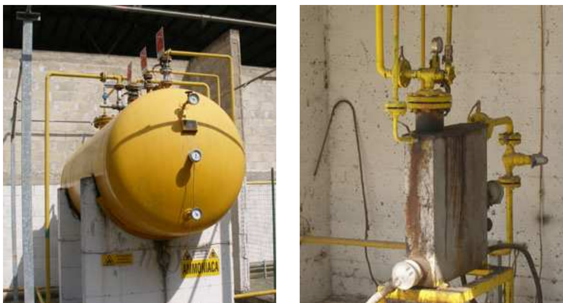
Figura 6.7: serbatoio di accumulo e vaporizzatore per l'ammoniaca anidra.
