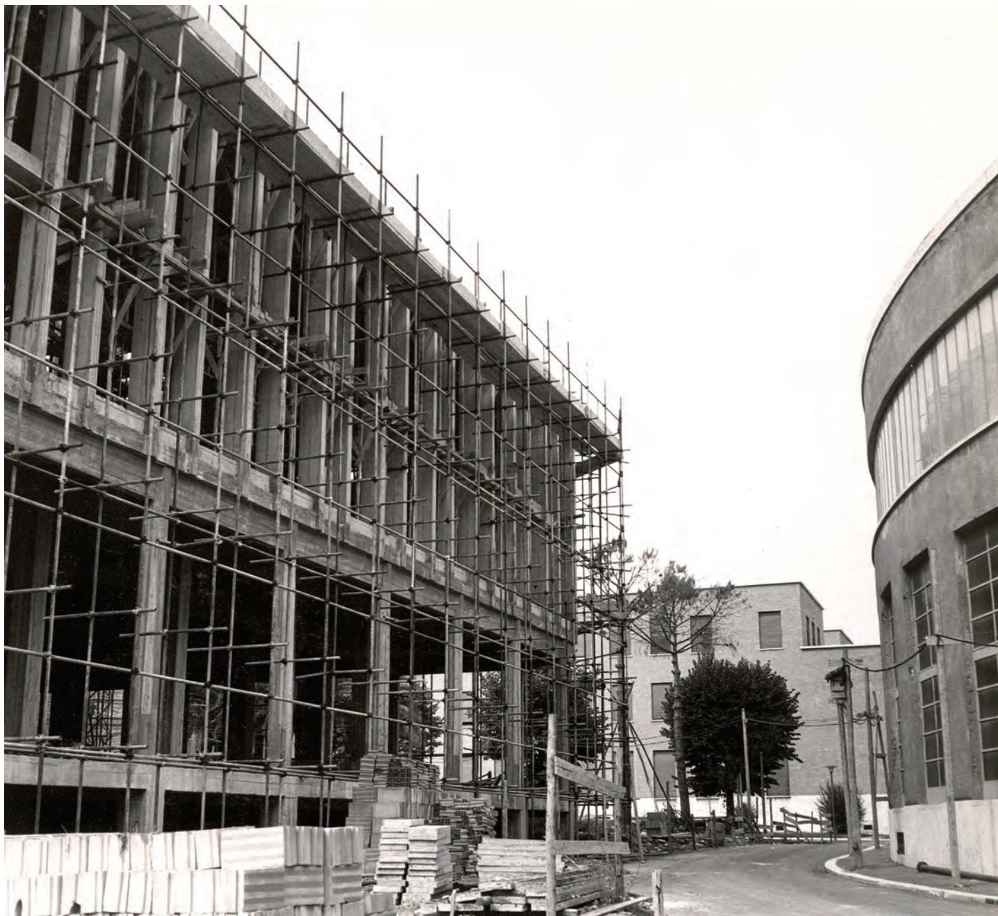
19. Istituto di chimica farmaceutica e tossicologia. Foto di cantiere (Asg, RI, p. 2a).
