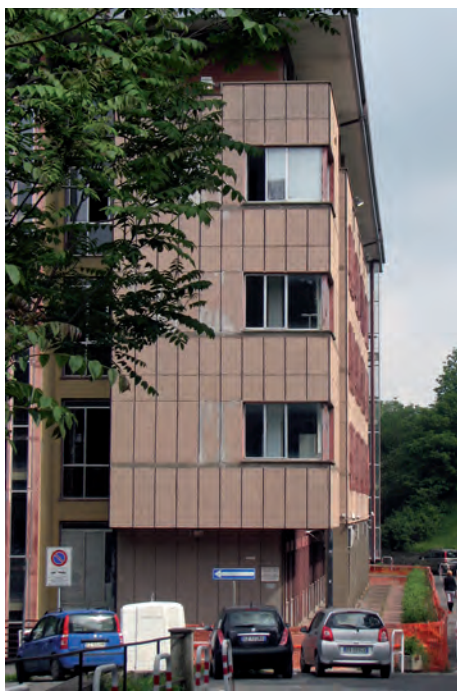
36, 37. Ospedale San Sebastiano a Frascati. Dettaglio dei bow-window e veduta d'infilata del fronte degenze con fenomeni di degrado.
