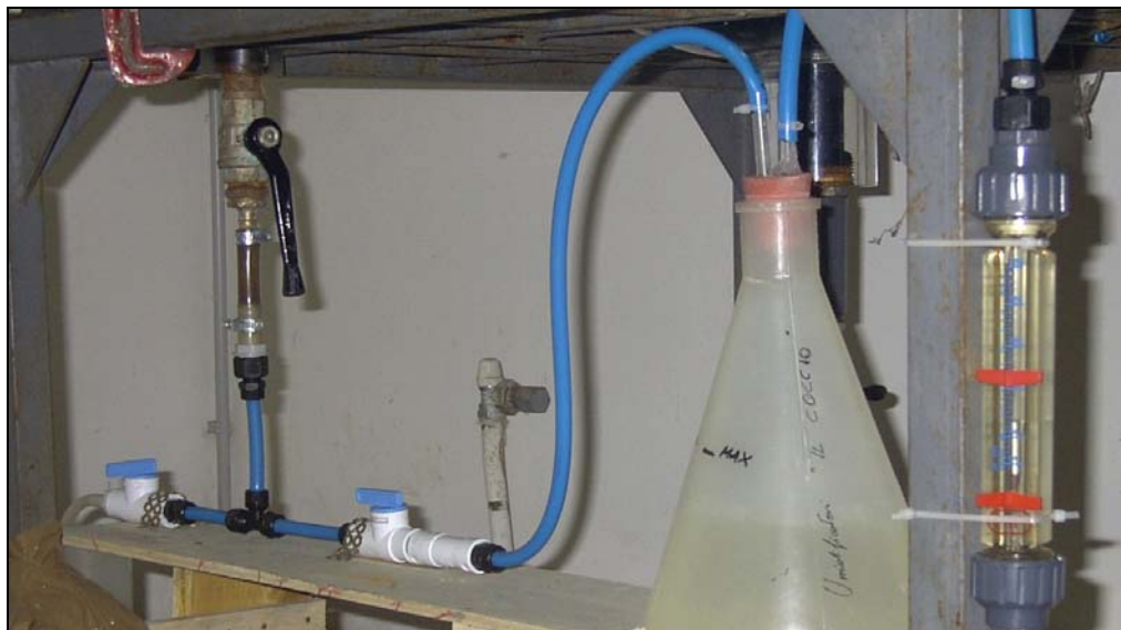
Figura 6. 11 – Particolare del valvolismo che ha consentito sia l'evacuazione del percolato che l'alimentazione dell'aria per mezzo di un compressore
