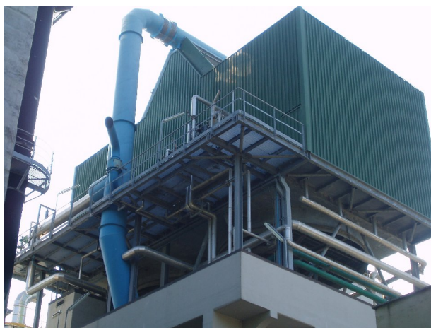
Figura 5.3: Vista del condensatore ad aria
