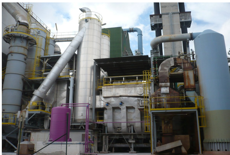
Figura 5.4: Vista delle unità per il trattamento dei fumi
